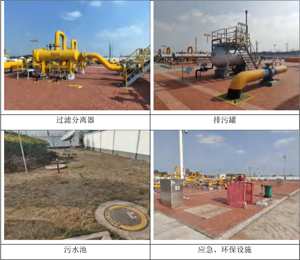
图 2.13-1 衡阳分输清管站现场照片
