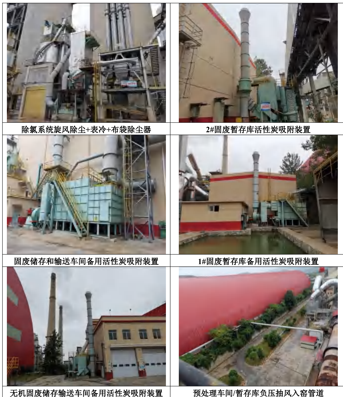
图 4.2-3 废气治理设施现场照片图
