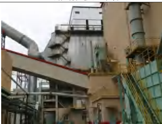
固废输送廊道布袋除尘器 1
