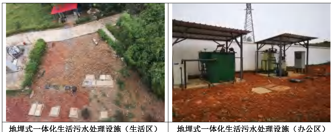
图 4.2-4 废水治理设施现场照片
