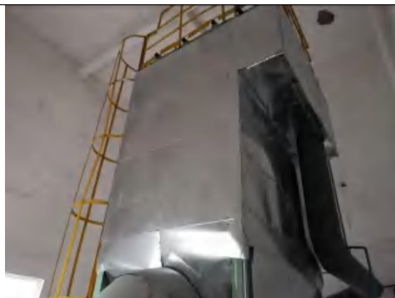
飞灰储存和输送车间布袋除尘器
