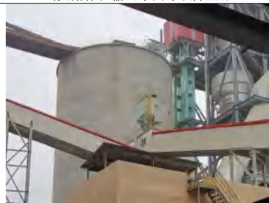
固废输送廊道布袋除尘器 2
