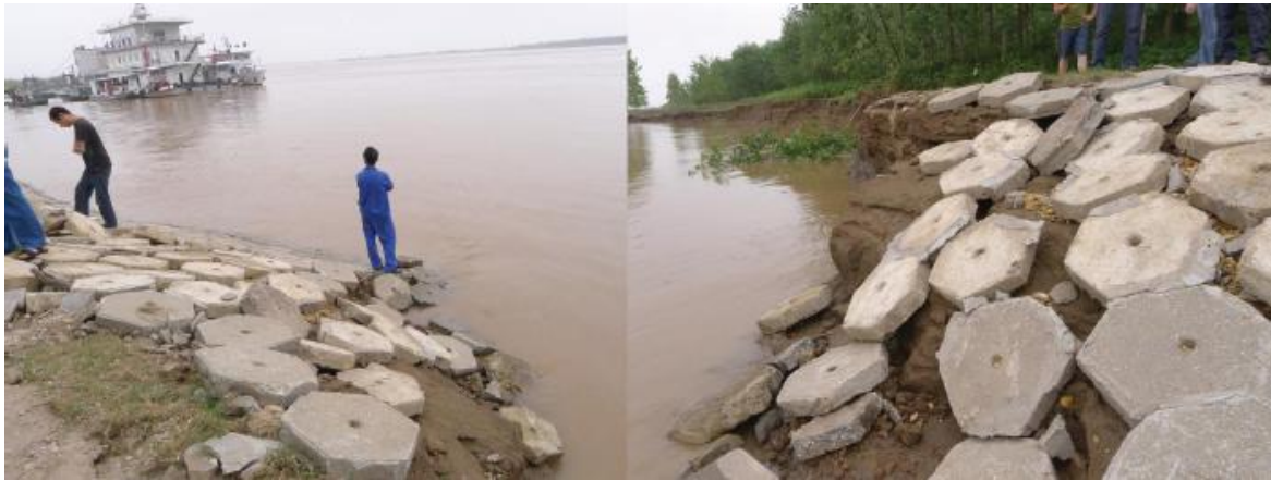
图 2.2-1 荆江门段崩岸险情
