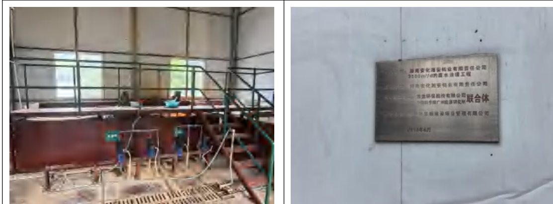
污水处理设施（2）
