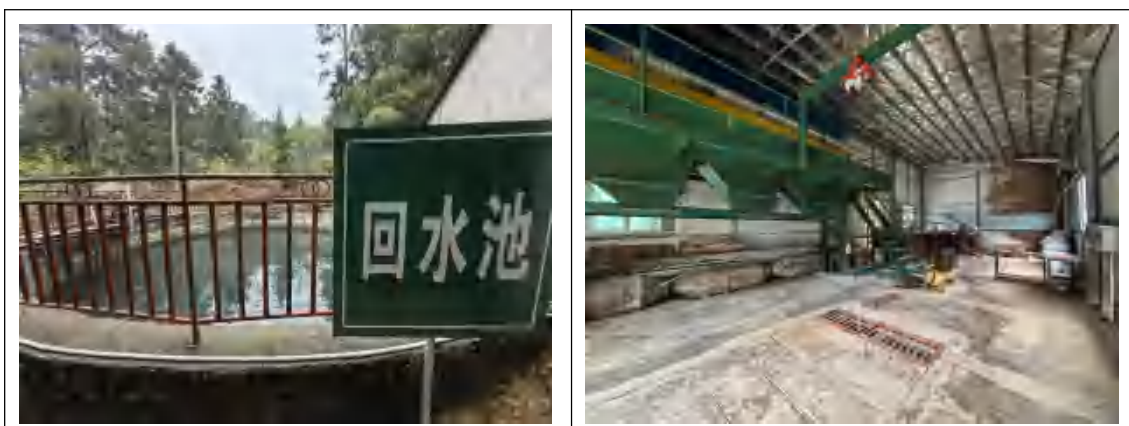
污水处理设施（1）
