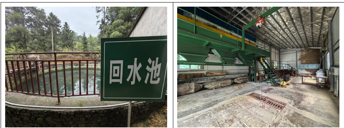
污水处理设施（1）
