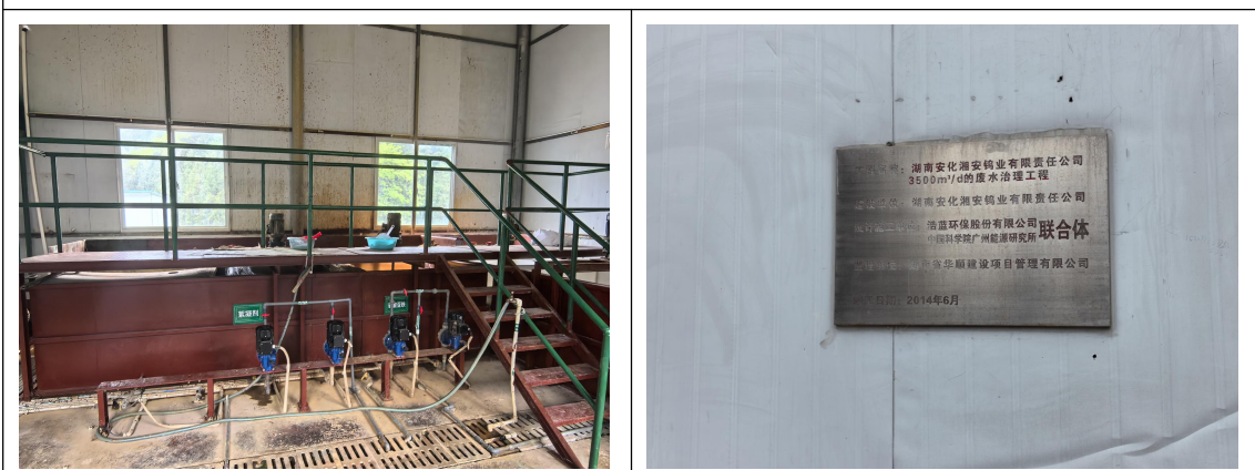
污水处理设施（2）
