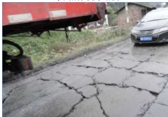
路面较差路段
