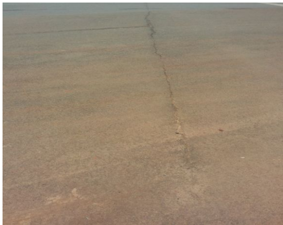
路面出现多条裂缝
