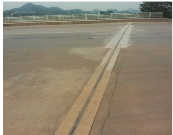
路面老化、破损
