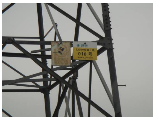
望江路沿线高压线
