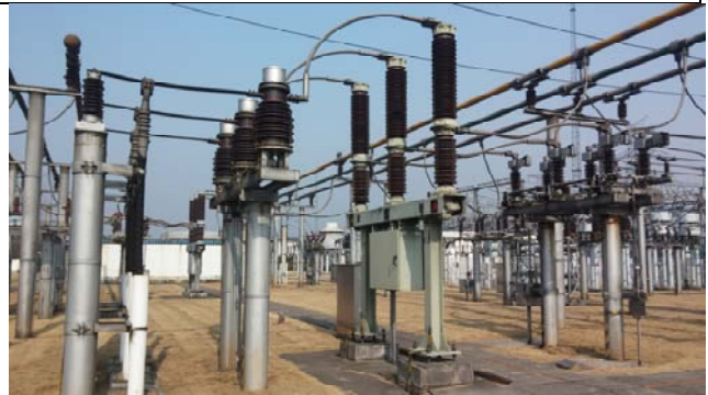
35kV 户外 AIS 配电装置
