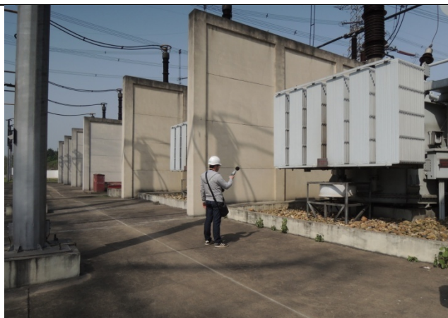
线路高压电抗器
