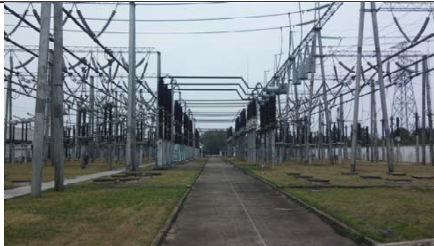
220kV 户外 AIS 配电装置
