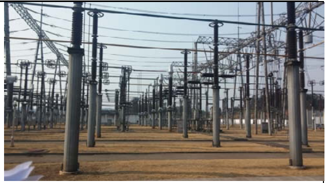
500kV 户外 AIS 配电装置
