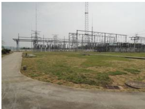
艾家冲变电站站内概貌
