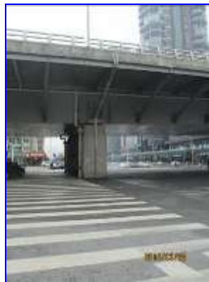
东岸引桥雨水收集系统
