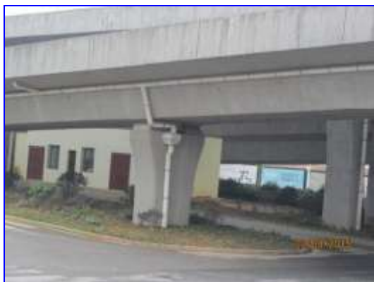
西岸引桥雨水收集系统
