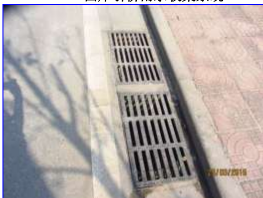
西岸接线道路雨水收集系统
