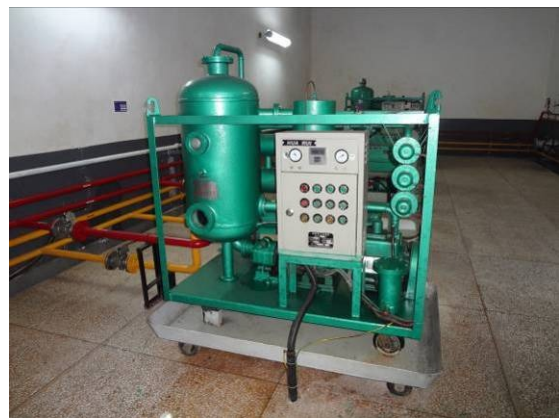
机组漏油收集设备
