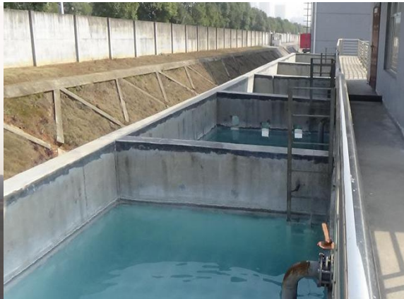
氧化车间废水处理站
