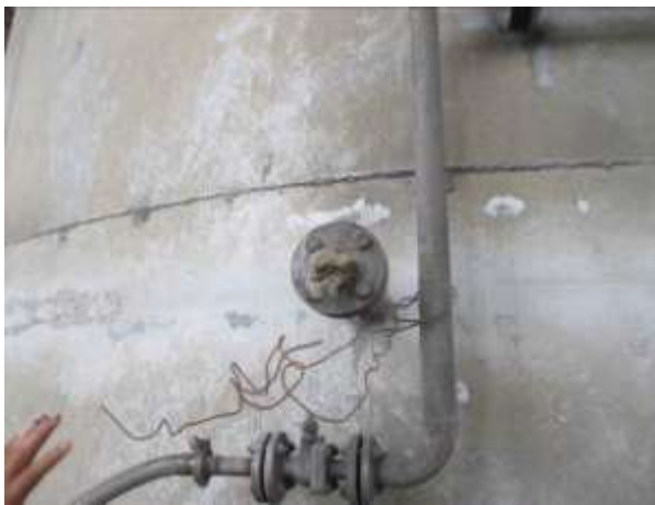
垃圾渗滤液喷枪插口
