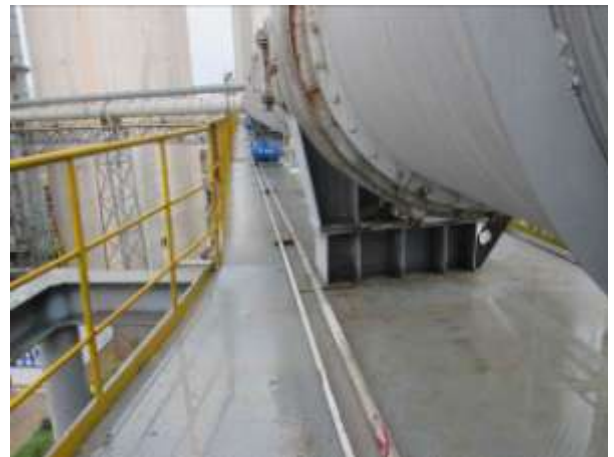
垃圾渗滤液输送管
