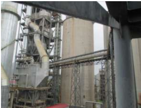
可燃气体输送管及恶臭气体输送管
