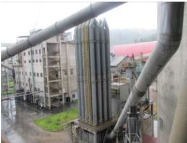
除氯系统气体冷却器
