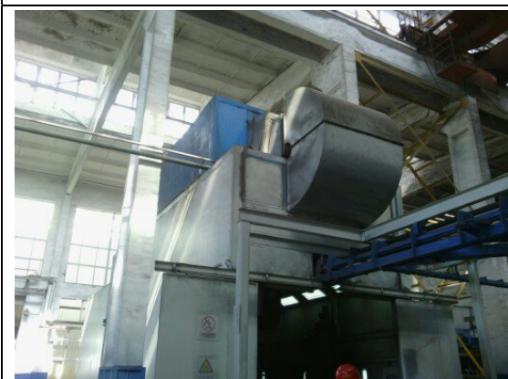
喷漆房及烘干房废气处理
