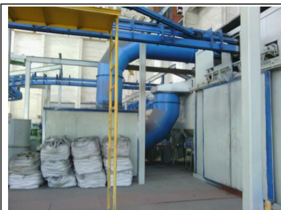
喷砂房废气布袋除尘
