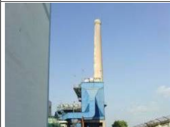
锅炉除尘器及烟囱
