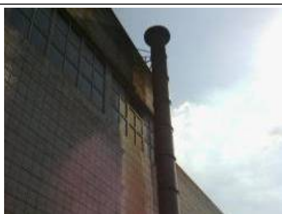
喷砂房废气排气筒
