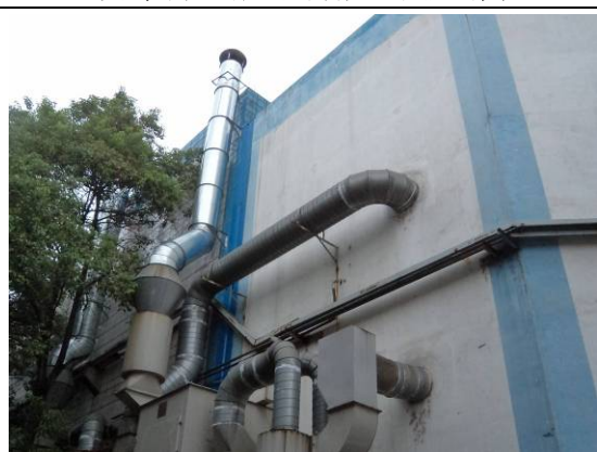
线圈绝缘车间除尘器及排气筒
