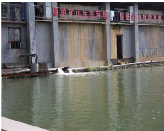
公司废水处理站
