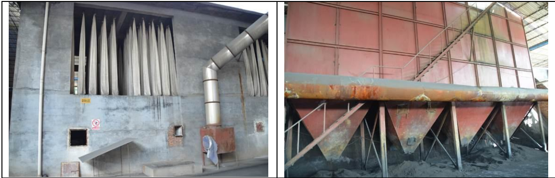
图 3.4-1 现有工程收尘设备
