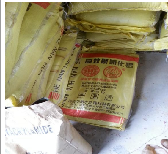
废水处理加药间
