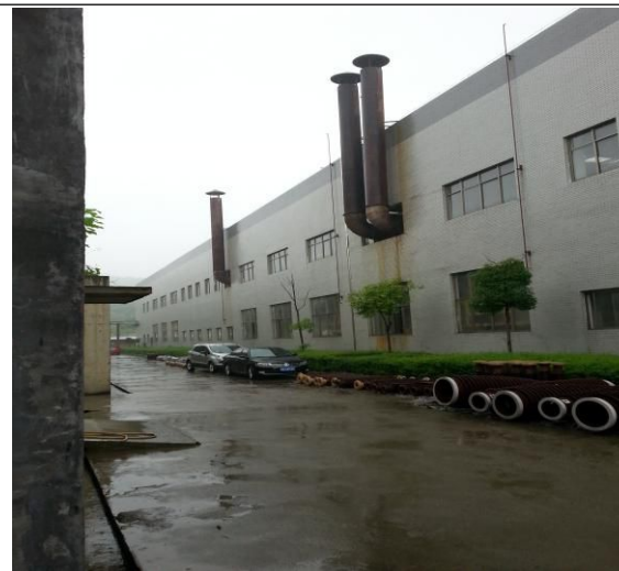
高瓷车间抽屉窑排气筒
