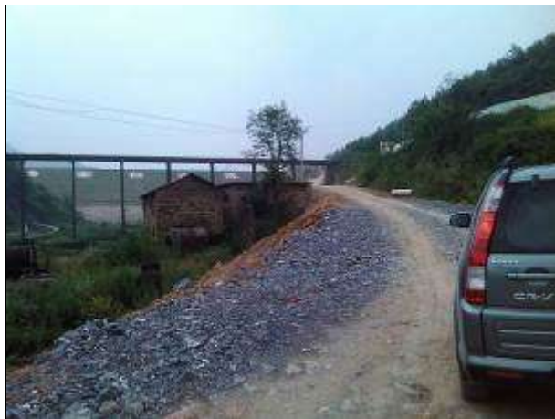
a 局部高路堤水毁病害
