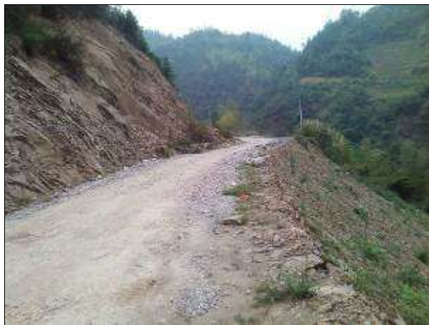
A 全线基本未做防护工程
