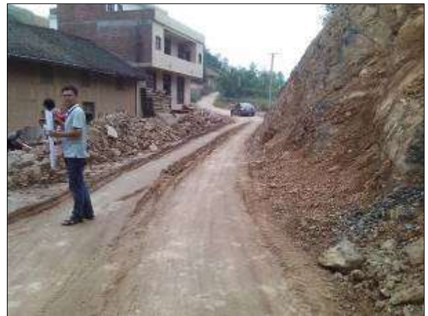
b 局部深路堑滑坡病害
