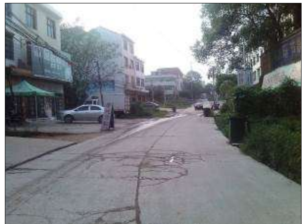
D 局部水泥砼路面断板破坏
