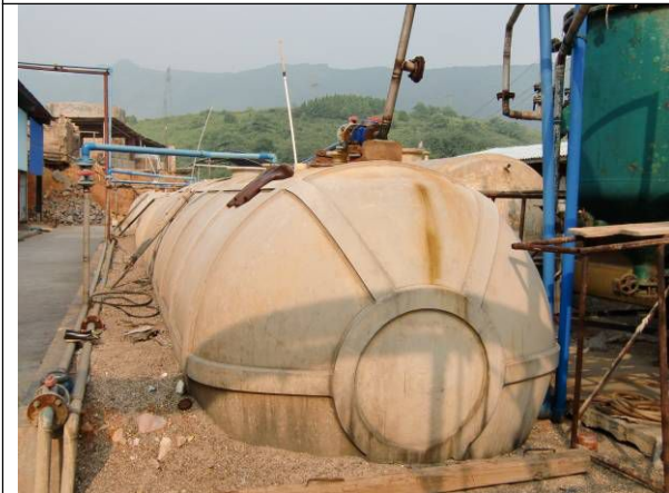
氯酸钠液体储存罐
