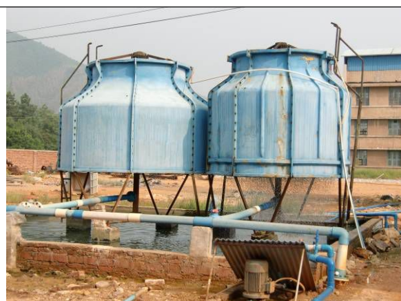
冷却电解槽的冷却塔
