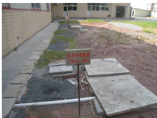
Gd-1 洗手废水收集池
