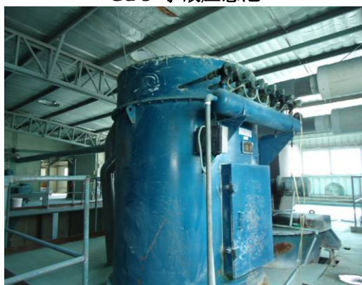
Gd-5 1号生产线前除尘器
