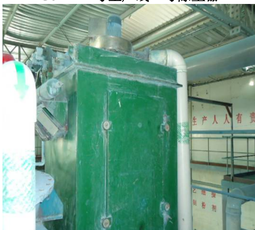
Gd-9 2号生产线3号除尘器
