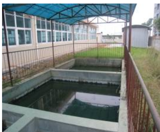
Ht-9 废水收集池
