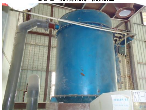
Gd-4 包装车间除尘器
