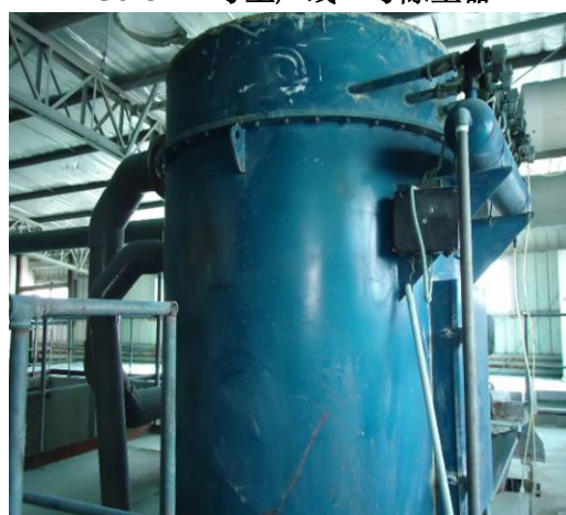
Gd-10 2号生产线4号除尘器
