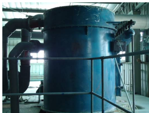
Gd-8 2号生产线2号除尘器
