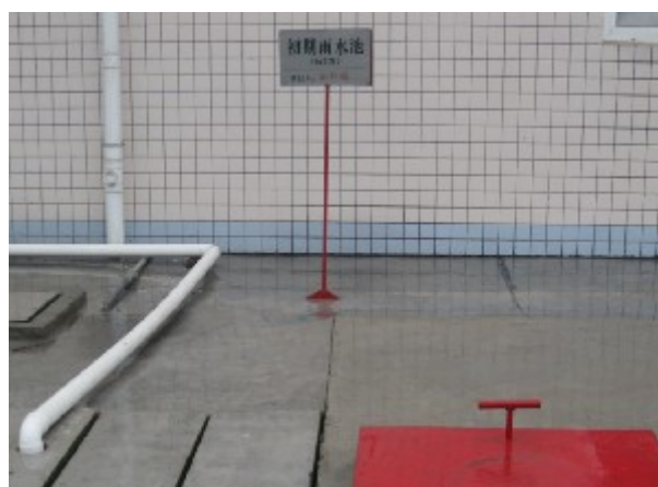
Wy-12 初期雨水收集池
