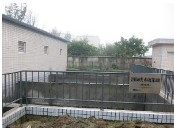
Wy-11 消防废水池
