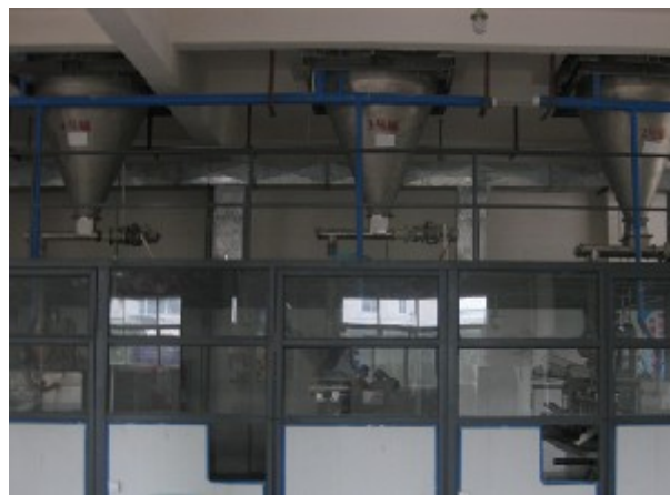
Wy-8 包装车间除尘 2
