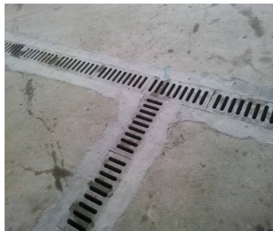
Ht-14 乳油车间废水收集沟
