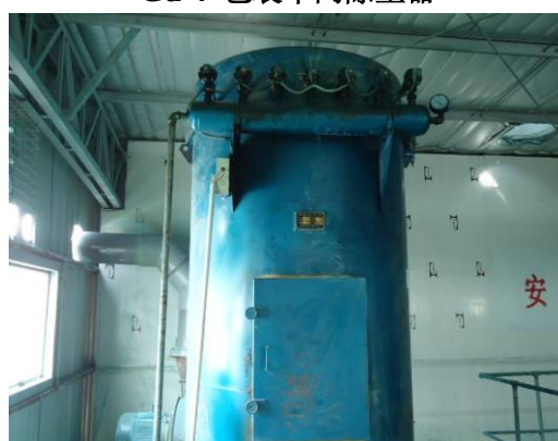
Gd-6 1号生产线后除尘器
