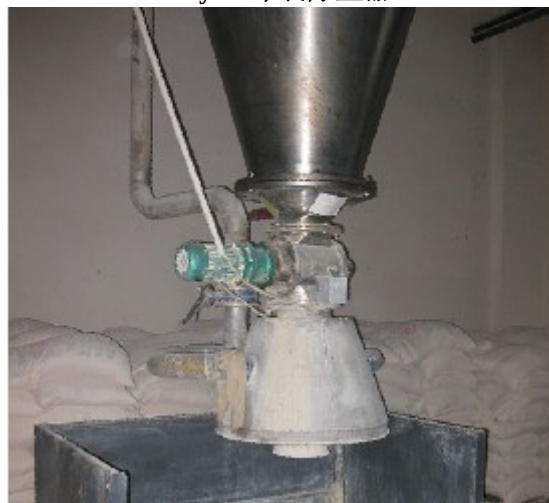
wy-6 下料除尘装置
