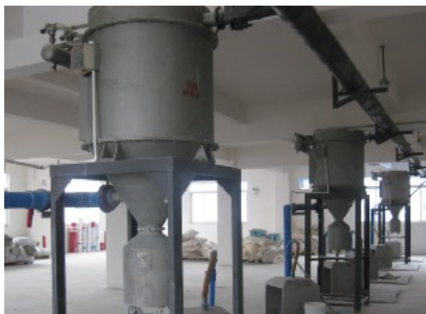
Wy-7 包装车间除尘 1
