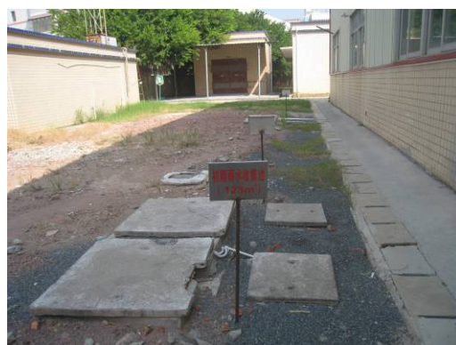
Gd-2 初期雨水收集池
