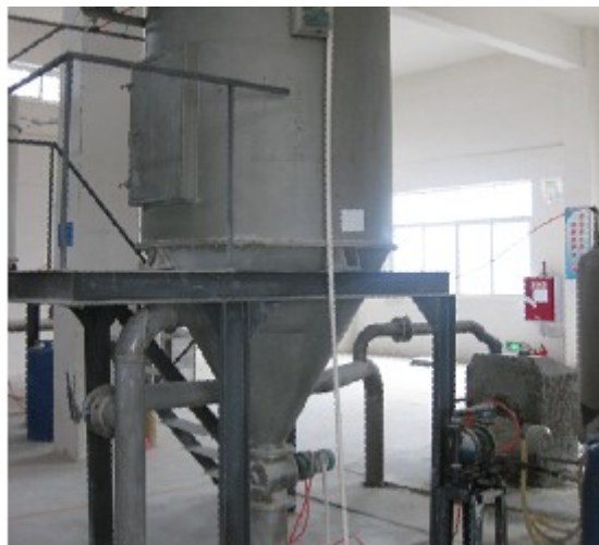
Wy-2 布袋除尘器 1
