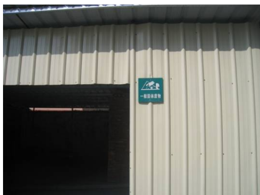
Gd-15 一般固废存储间
