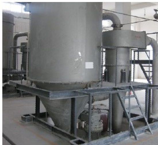
Wy-4 布袋除尘器 3
