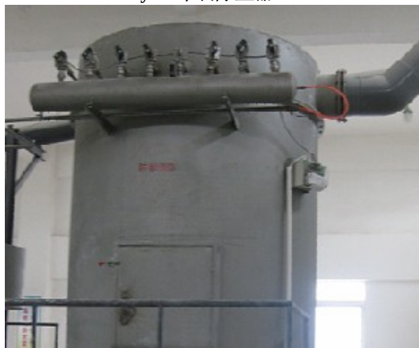
Wy-5 布袋除尘器 4
