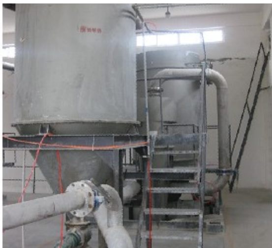
Wy-3 布袋除尘器 2
