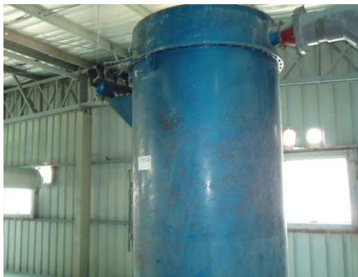
Gd-7 2号生产线1号除尘器
