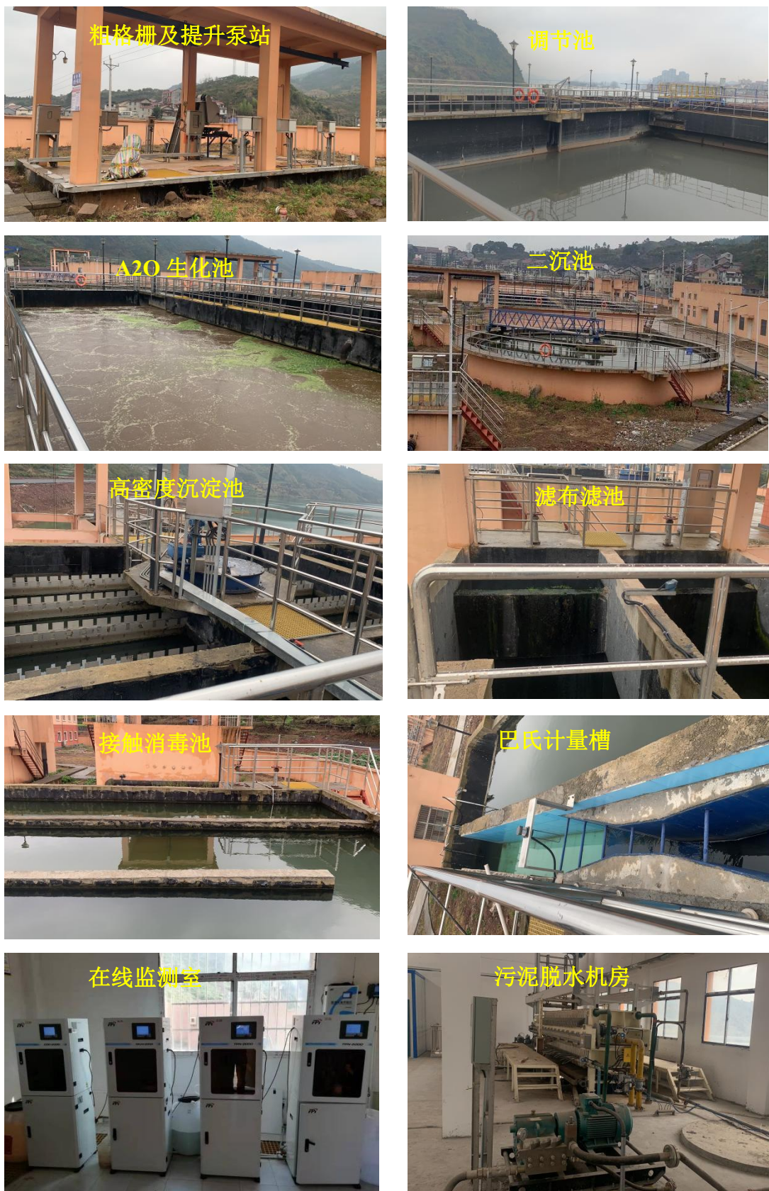
图 2.2-4 泸溪高新区污水处理厂现状图
