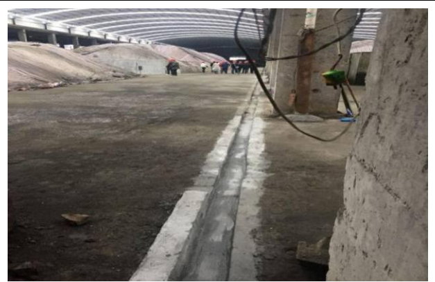
危废渣库渗滤液收集沟
