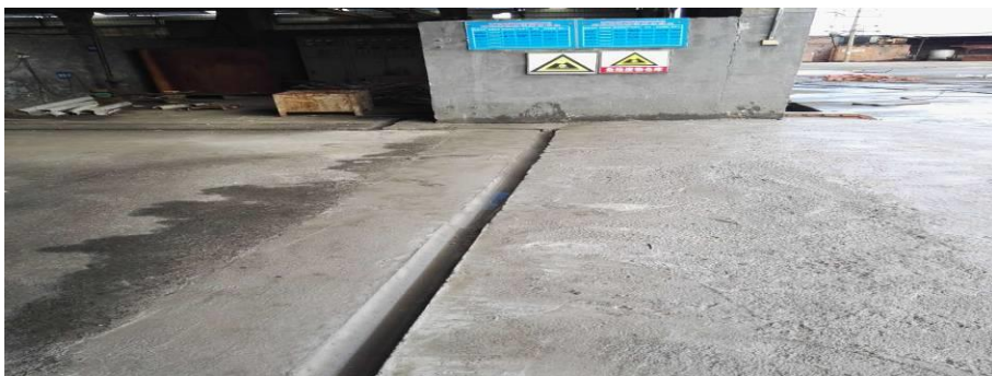
危废渣库，环形渗滤液收集沟及进出口挡水坎
