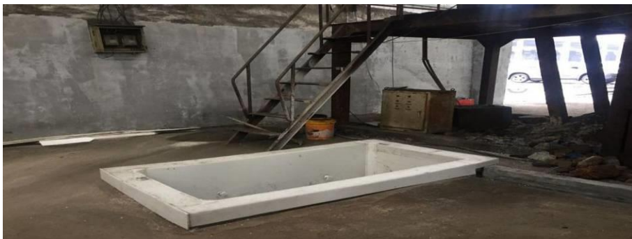
危废渣库渗滤液收集槽
