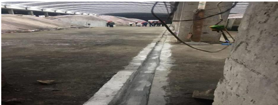
危废渣库，环形渗滤液收集沟
