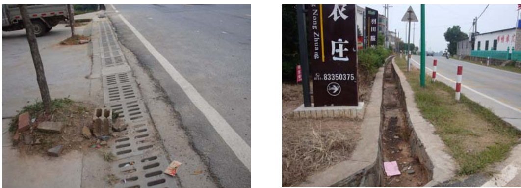
图7-2 公路沿线排水设施
