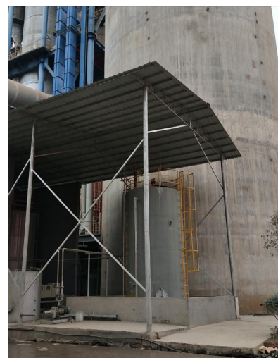
风险控制（氨罐周围设置了围堰）
