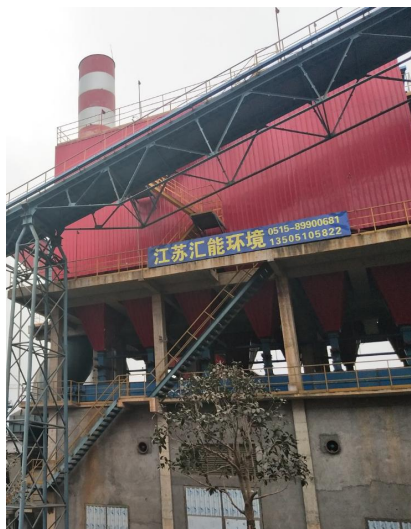
废气处理设施（除尘器）
