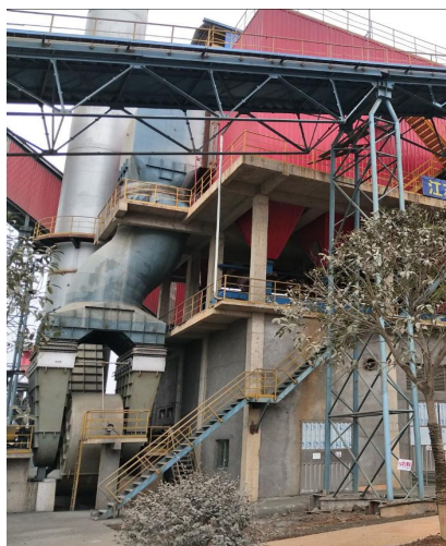
废气处理设施（窑尾脱硝设施）
