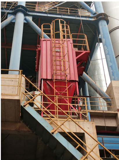
生料入库斗提 (除尘设备)
