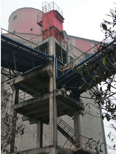
熟料库库顶 (除尘设备)
