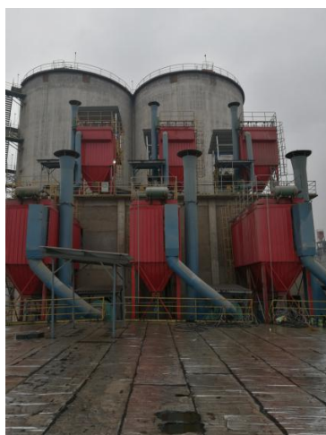
水泥包装机（除尘器）
