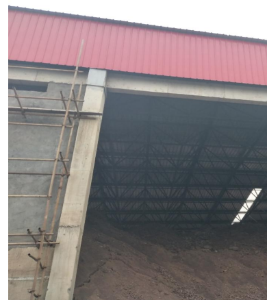
防尘设施（原料堆棚）
