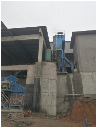
锤式破碎机 (除尘设备)
