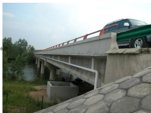
图 8.4-2 孝襄高速陨水河桥面径流收集装置
