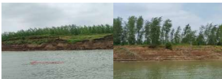
图 3.4-4 濠河口河段崩塌岸坡现状图
