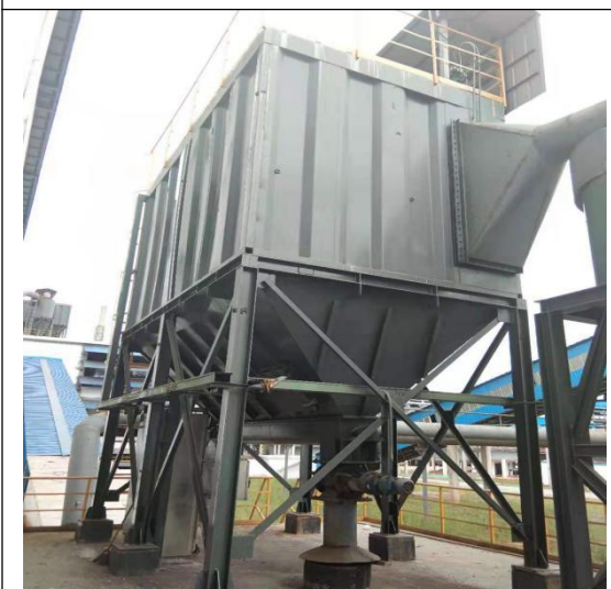
锌精矿仓东侧废气处理设施
