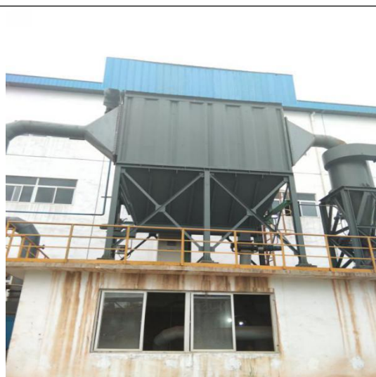
锌精矿仓西侧废气处理设施
