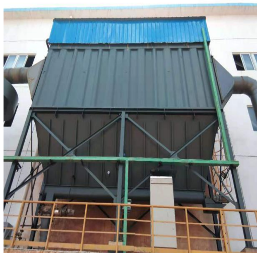
锌浸出渣贮仓上料废气处理设施
