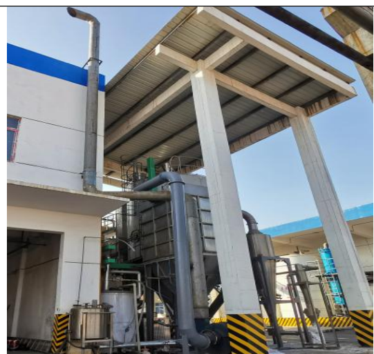
污酸处理硫酸钠喷雾干燥废气除尘器
