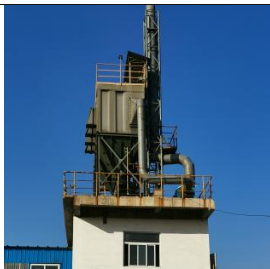
焦粉中转站焦粉输送系统废气处理设施及排气筒
