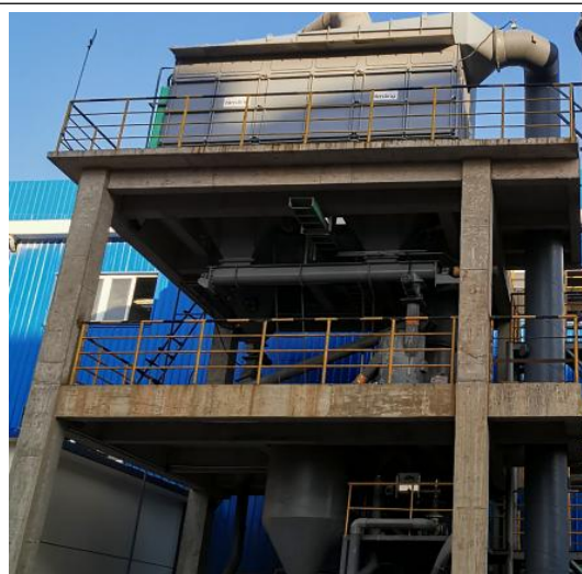
镉精炼系统废气治理设施
