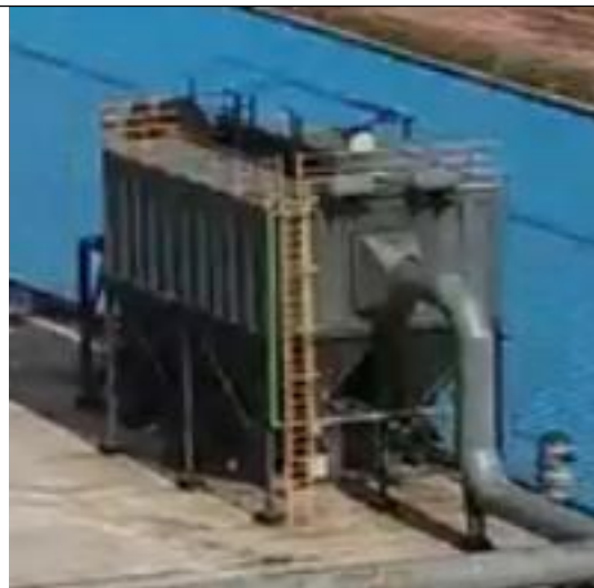
锌精矿仓上料废气处理设施
