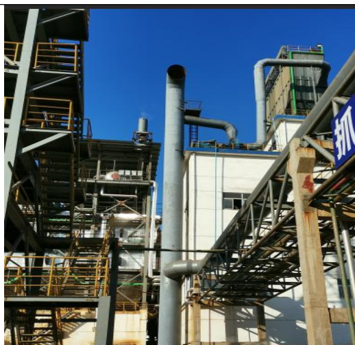
多膛炉及挥发窑上料系统废气
