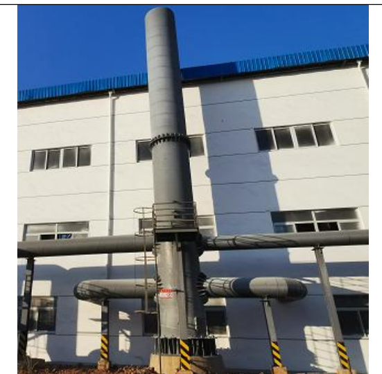
锌粉制造车间废气排气筒
