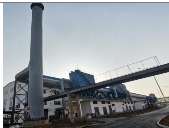
锌熔铸车间废气处理设施及排气筒
