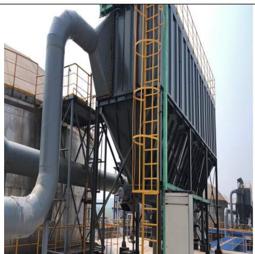
2#焙烧车间上料废气处理设施
