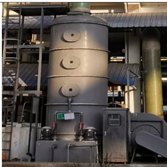
镉回收酸浸槽置换废气酸雾净化系统
