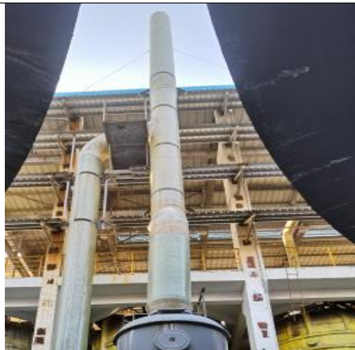
除铜除氯、扫镉除油槽废气排气筒
