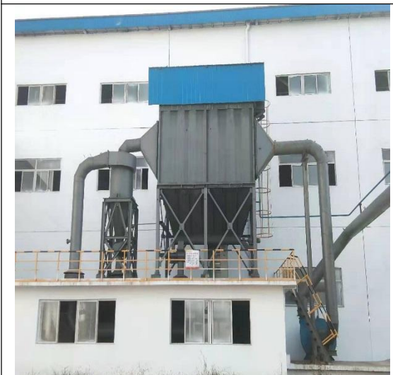
锌精矿上料收尘设施
