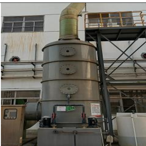
铜回收车间置换间废气净化系统
