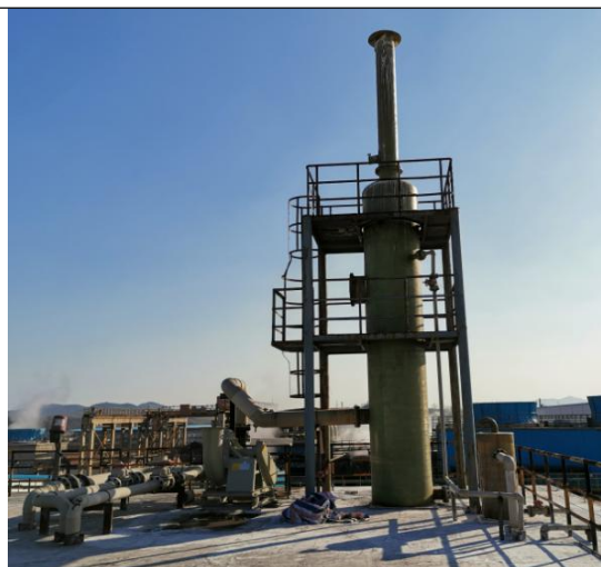
污酸处理硫化反应尾气除害塔
