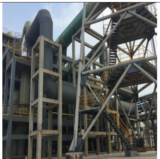
离子液脱硫装置烟气管道
