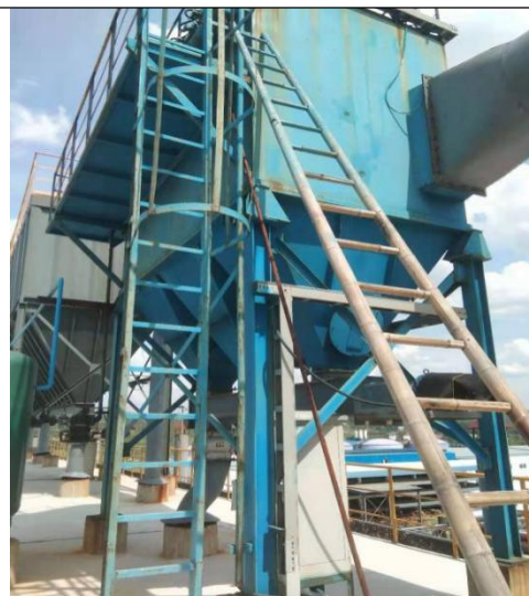
多膛炉上料废气处理设施
