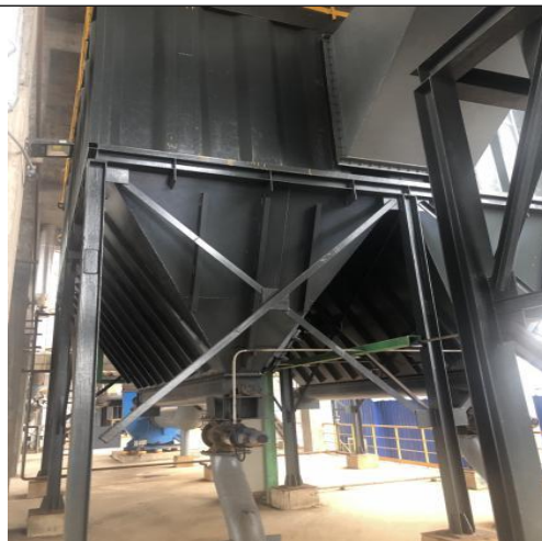
1#焙烧车间下料废气处理设施
