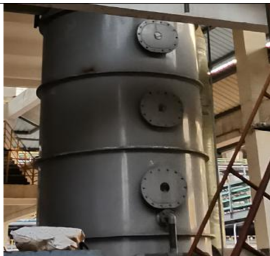
氧化锌浸出车间酸雾处理设施
