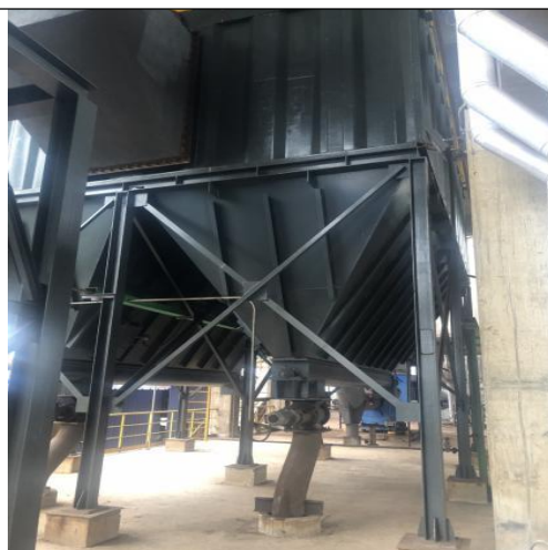
2#焙烧车间下料废气处理设施
