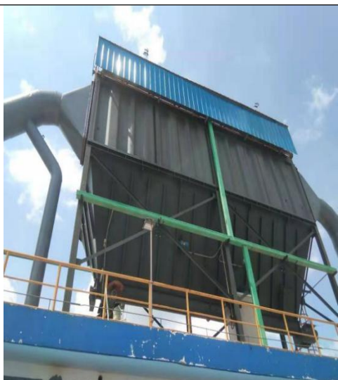
多膛炉上料废气处理设施
