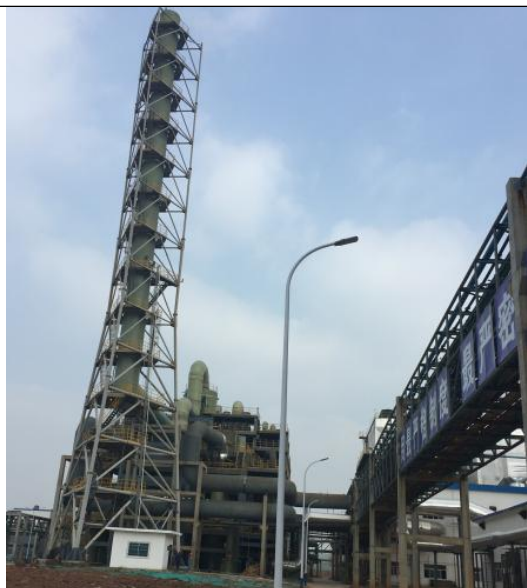
挥发窑及多膛炉除尘脱硫烟气管道及排气筒
