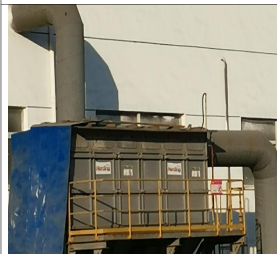
锌粉制造车间废气处理设施
