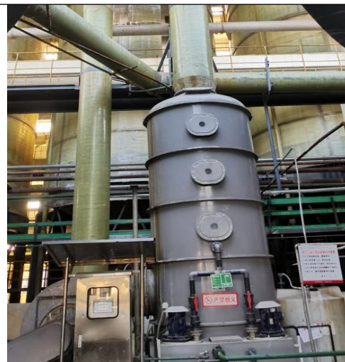
除钴镍槽酸雾处理设施
