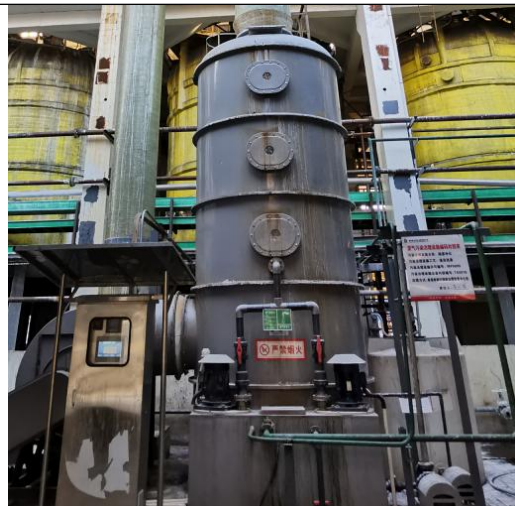
除铜除氯、扫镉除油槽酸雾处理设施
