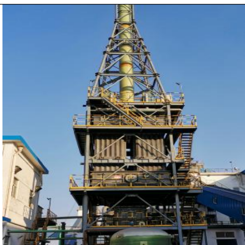
锌精矿干燥窑废气处理设施及排气筒
