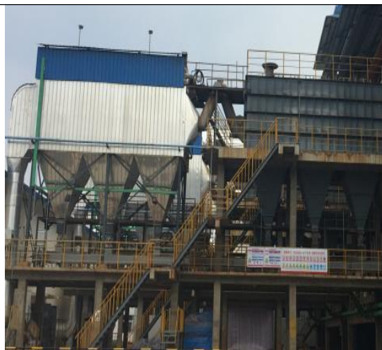
多膛炉上料废气处理设施
