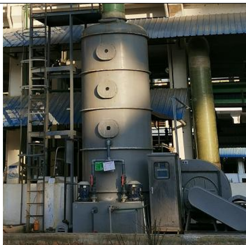
铜回收酸浸置换废气酸雾净化系统
