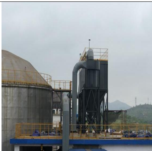
1#焙烧车间上料废气处理设施
