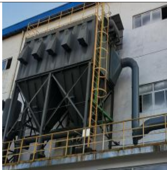
挥发窑焦粉仓上料废气处理设施
