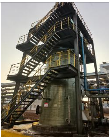
焙烧车间开炉烟气洗涤塔
