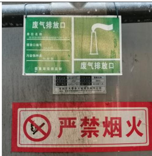
除铜除氯、扫镉除油槽废气排气口标识牌
