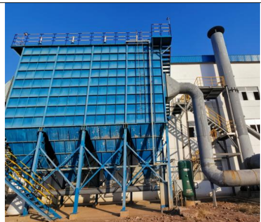
锌浮渣处理车间废气处理设施及排气筒
