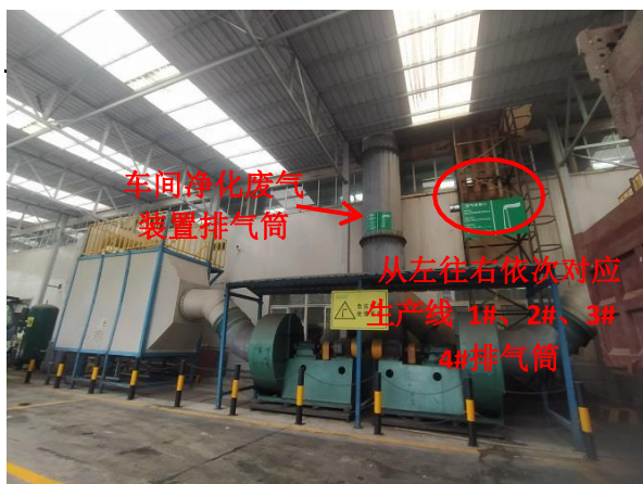
废气处理装置配套排气筒(5 根
