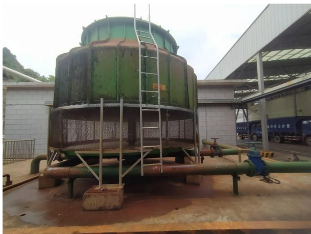
循环水处理系统
