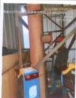
2#高温蒸煮处理废气出口
