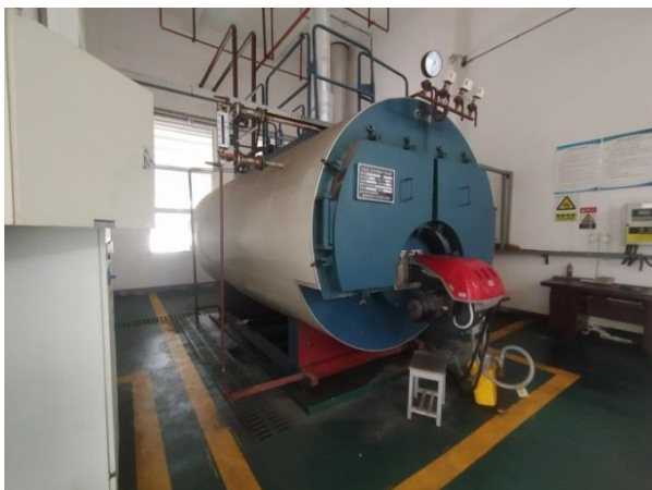
备用燃油锅炉
