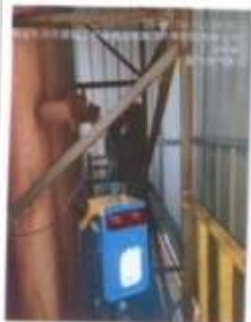
1#高温蒸煮处理废气出口
