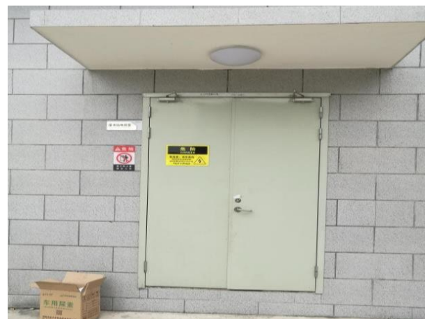
废水处理站电控室
