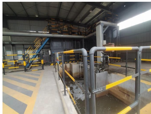
厂内污水处理站
