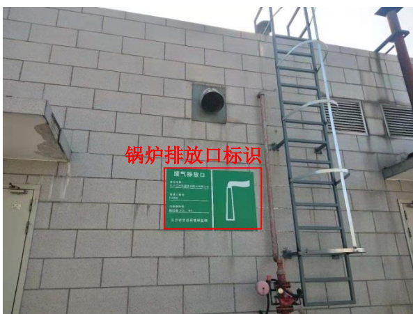
锅炉排放口标识
