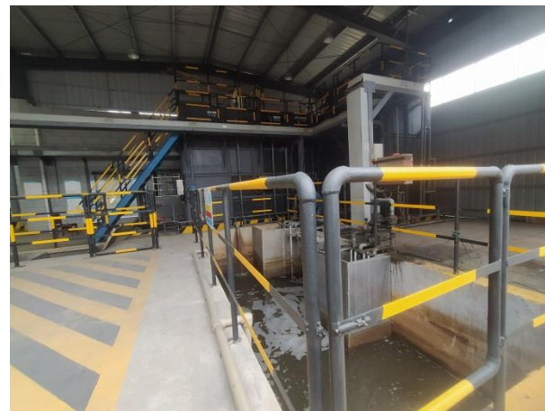
厂内污水处理站
