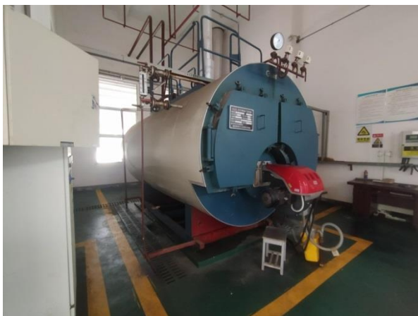
备用燃油锅炉
