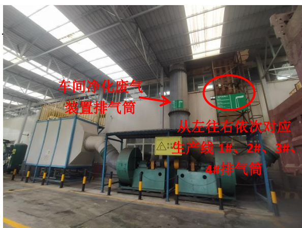
废气处理装置配套排气筒(5 根)
