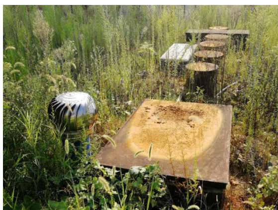
锁石收费站污水处理设施
