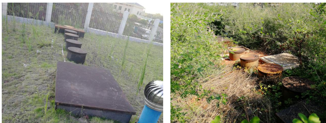
祁东收费站污水处理设施
