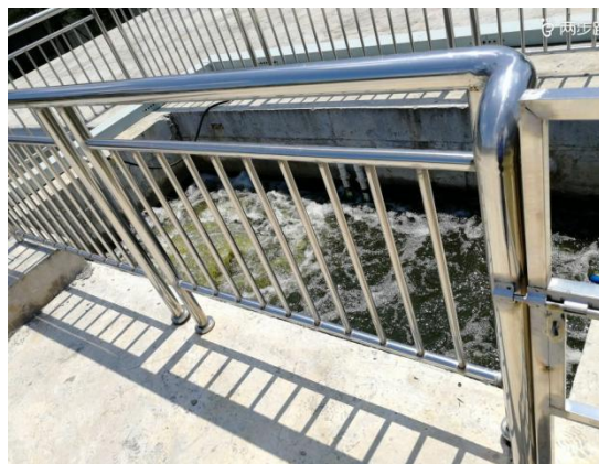
双峰服务区污水处理设施
