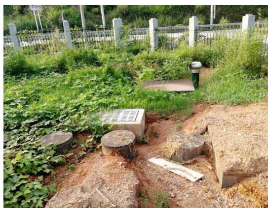
洪市收费站污水处理设施
