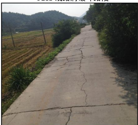
X055 线水泥路面现状
