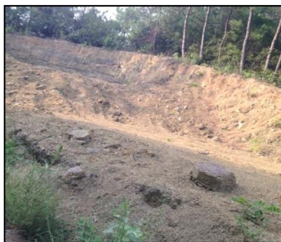
Y283 线边坡滑塌路段
