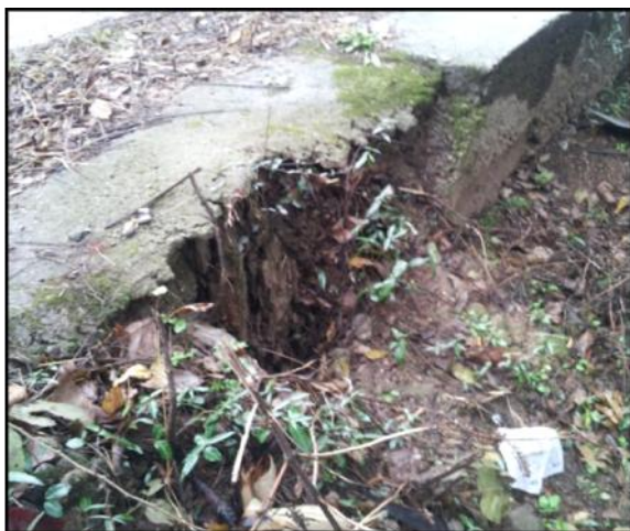
Y283 线路肩破坏路段
