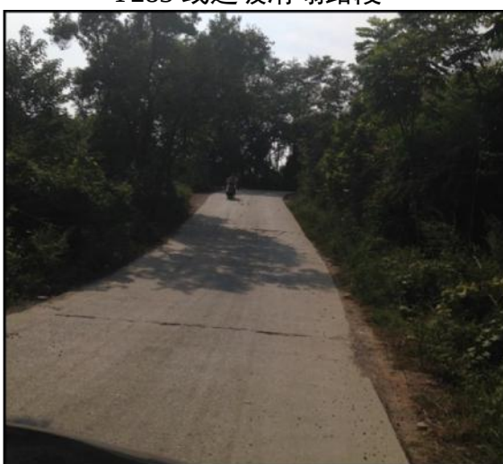
X055 线坡陡弯急路段
