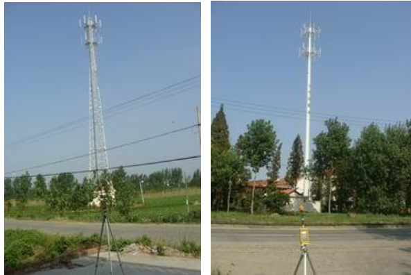
图 3-10 乡镇基站典型的天线架设方式
