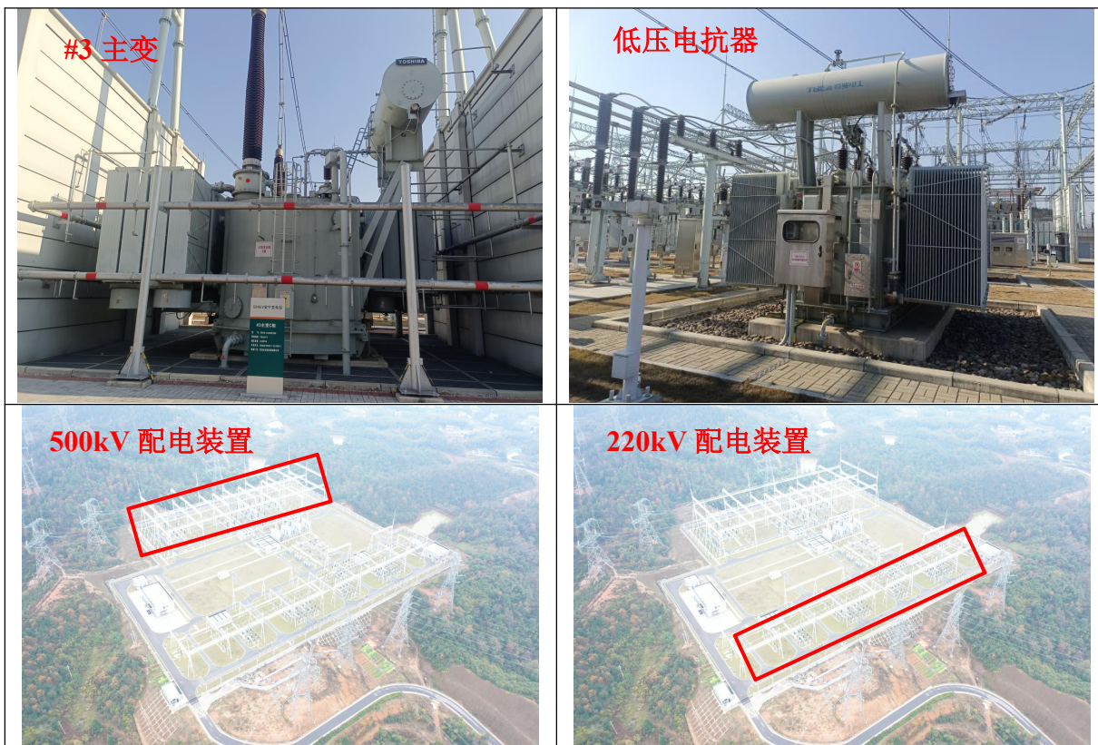
图 3-1 安宁 500kV 变电站现有电气设备建设情况
