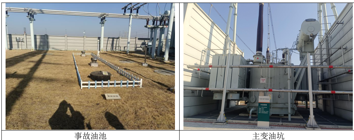
图 3-2 安宁 500kV 变电站内事故油池、主变油坑
