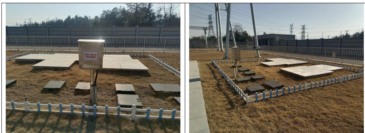
图 3-3 安宁 500kV 变电站地埋式污水处理设施
