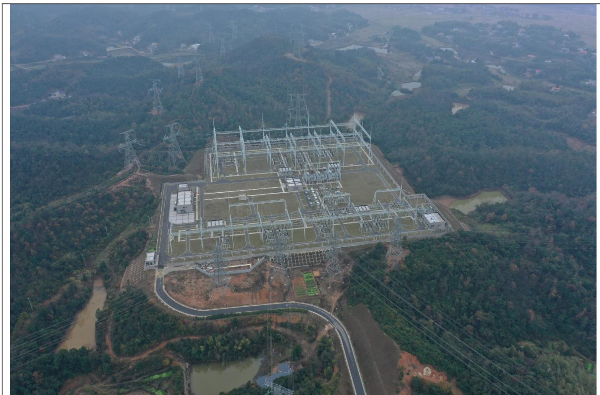
图 3-4 安宁 500kV 变电站现状
