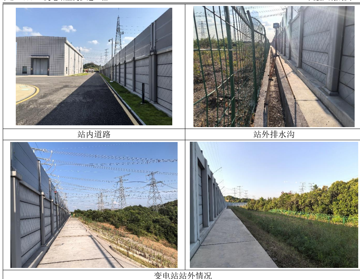
图 4-2 变电站站址已建生态保护措施及周边生态环境现状
