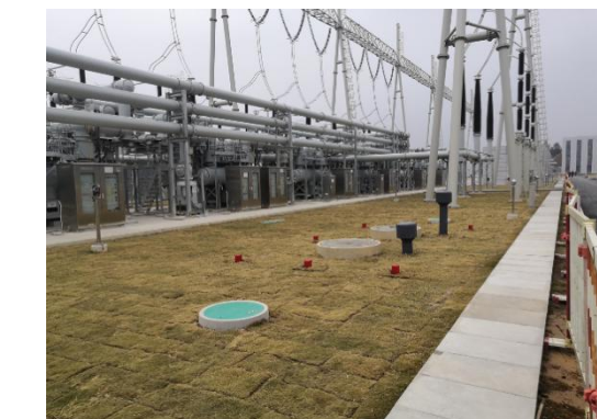
站用变事故油池
