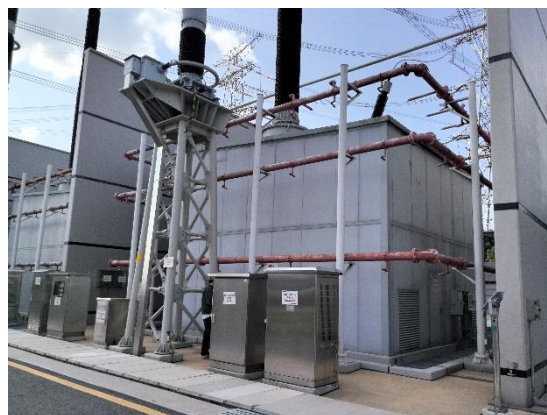
高压电抗器防火隔声墙+Box-in
