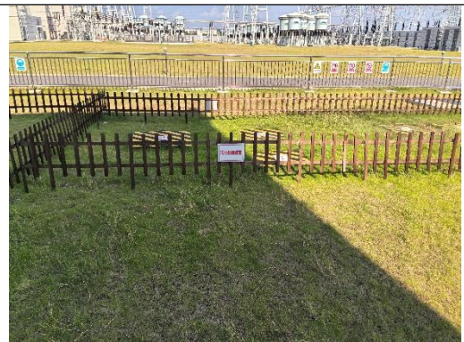
生活污水处理装置
