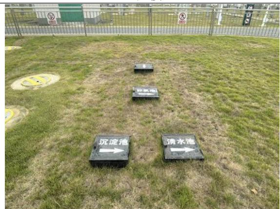
地埋式污水处理装置
