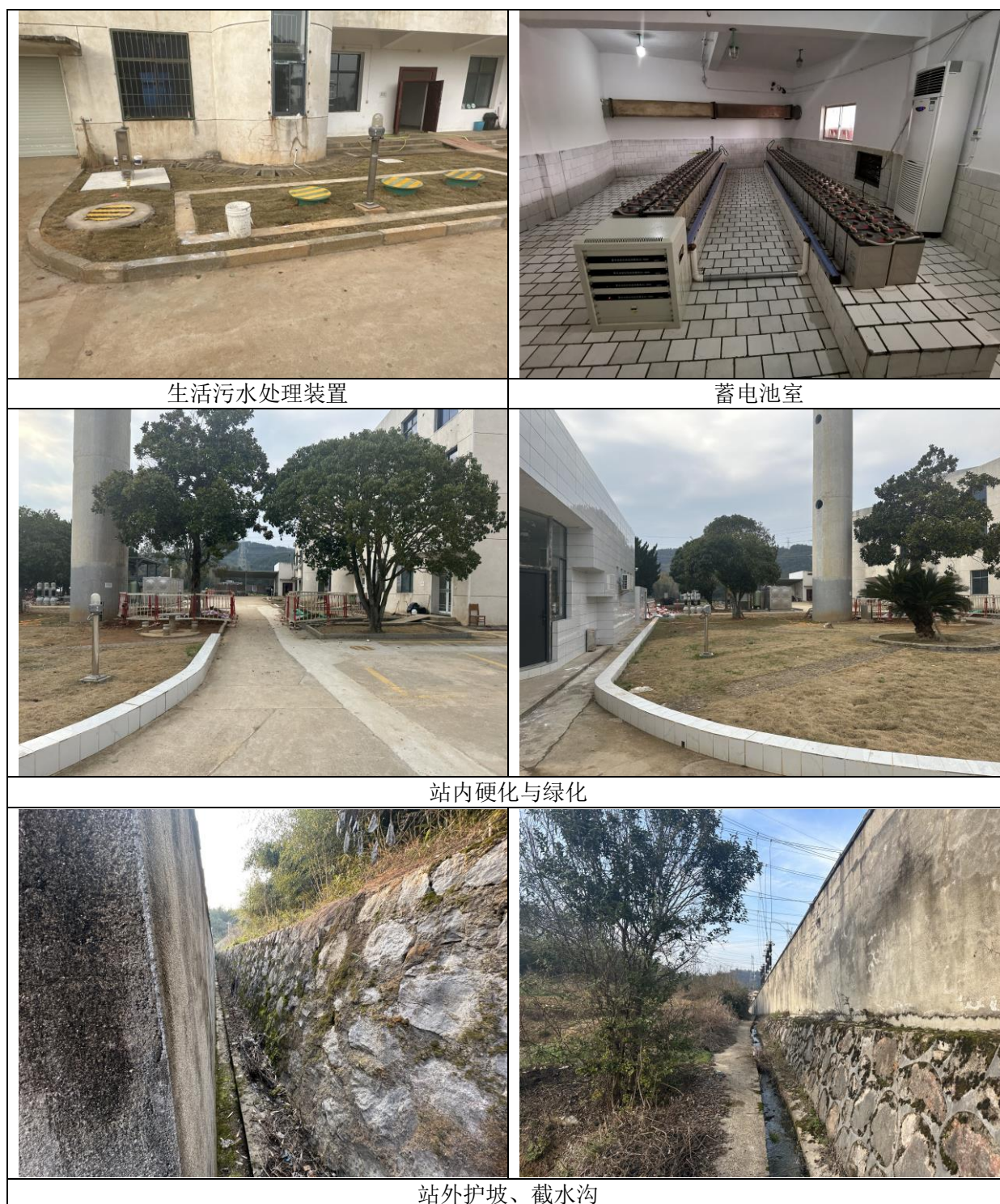
图 3-2 民丰 500kV 变电站现状照片
