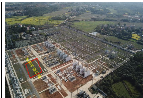
岗市 500kV 变电站
