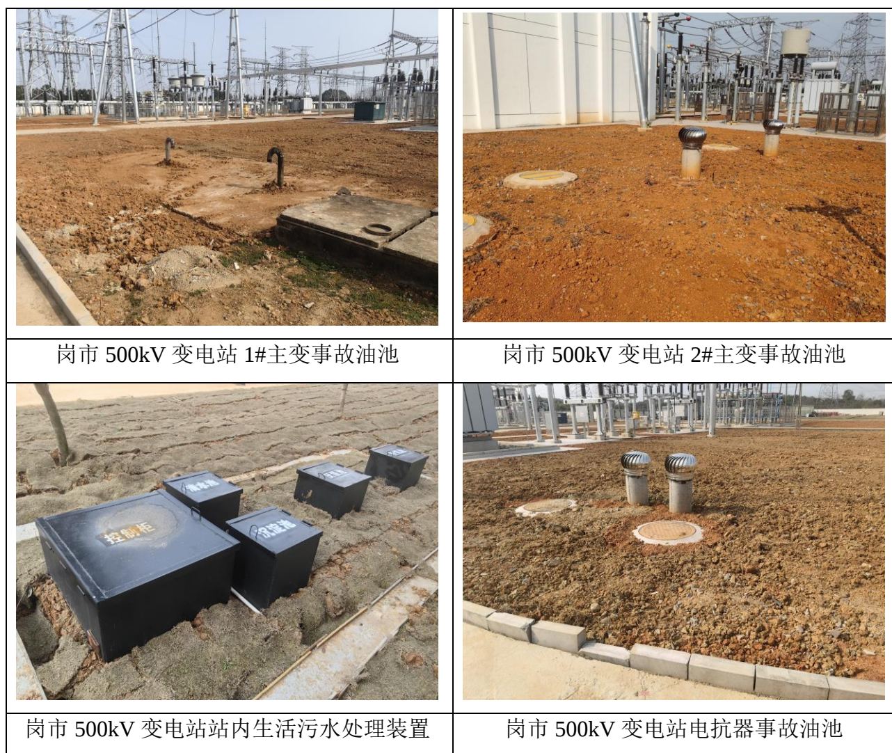
图 3-1 岗市 500kV 变电站站内环保设施
