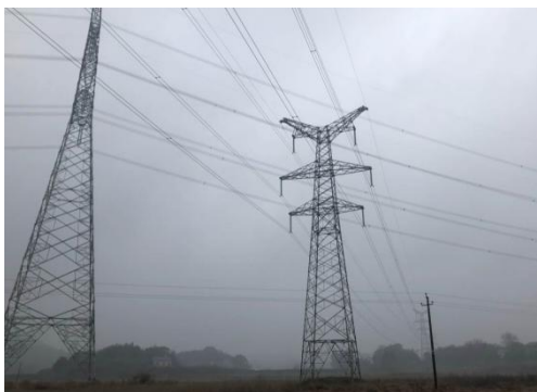
跨越 220kV 宗柏线处
