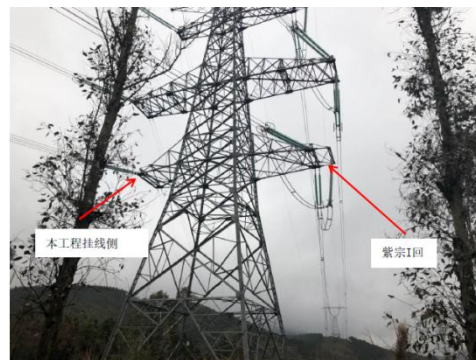
本工程线路紫宗 I 线 052#分支塔
