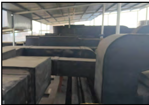
DSA 机房楼上
