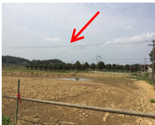
500kV 复艾二回
