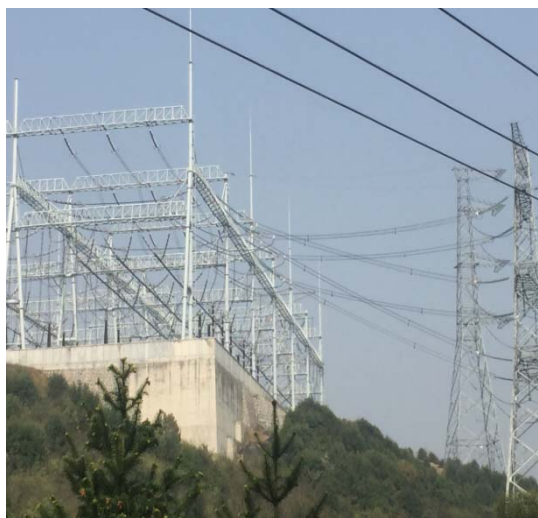
鼎功变500kV出线龙门架
