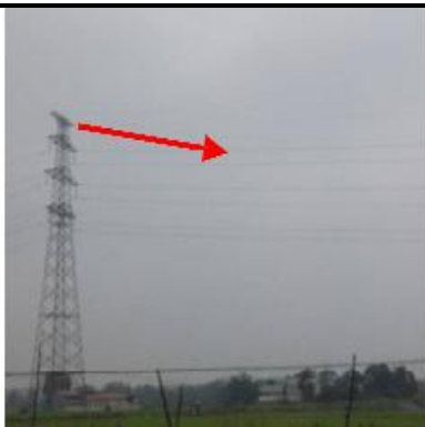
图 1-2 跨 110kV 沧长线
