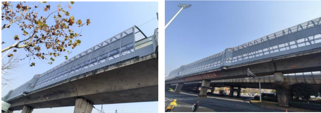
图7 长沙1号线中信广场至尚双塘区间全封闭声屏障
