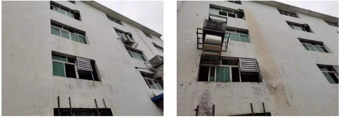
图4 企业排风口从顶楼改到二楼（整改前后对比图）
