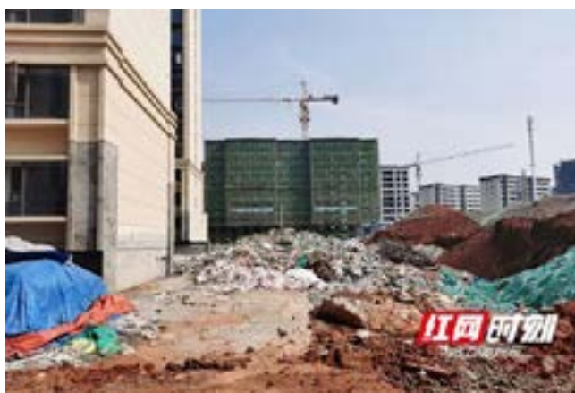
施工现场建筑垃圾未及时清运、在场内堆存的，未采用密闭式防尘网遮盖
