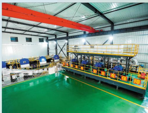
餐厨垃圾预处理车间
